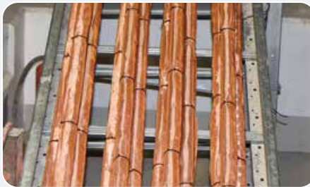
Stromkabel, Daten- und Versorgungsleitungen
